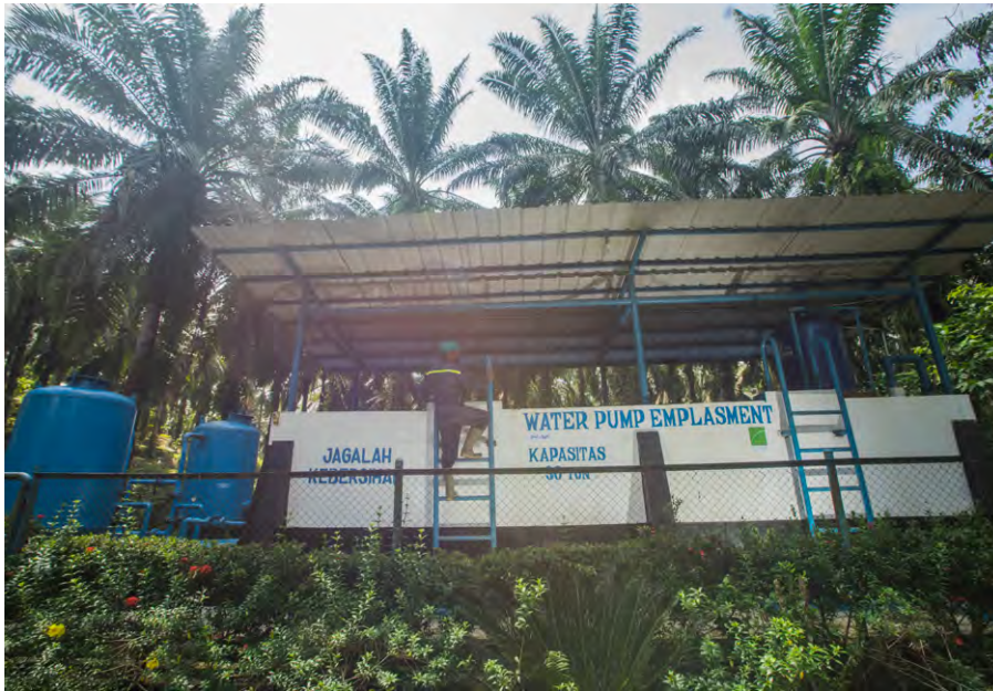
Water Pump Emplasmnt in Pulo Rambong Estate, North Sumatra Emplasmnt Pompa Air di Perkebunan Pulo Rambong, Sumatera Utara
