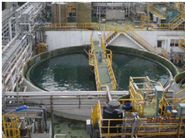
混凝沉澱處理
