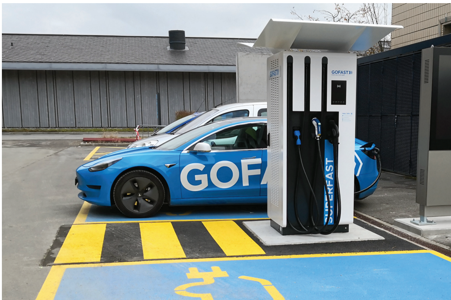
Station de recharge pour deux voitures électriques sur le campus de l'EPFL. Photo : MESH4U
