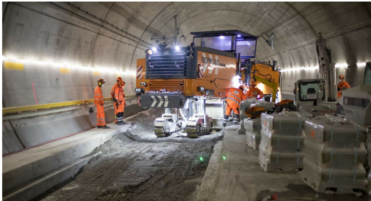
Ogni settimana vengono fresati circa 300 metri di binario: la fresatrice in azione.
