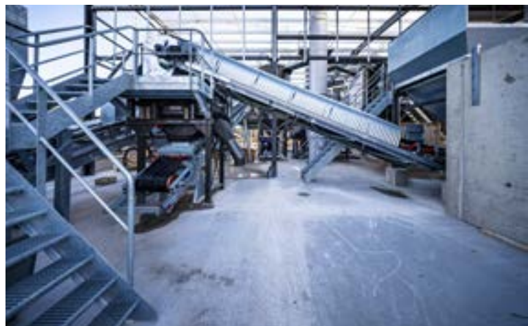
< Moderniser nos installations industrielles permet d'augmenter le taux de recyclage de nos gammes d'enrobés.
