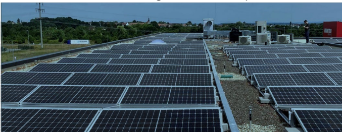
Photovoltaik-Anlage bei der axicorp in Friedrichsdorf
